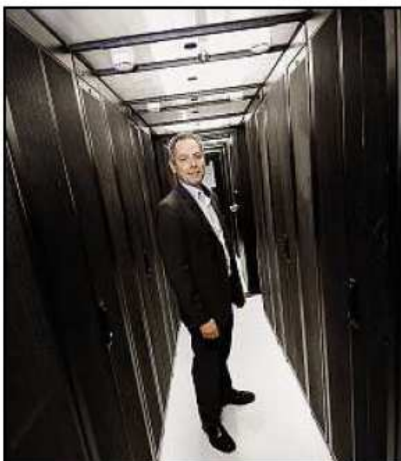
SERVEURS. Frédéric Chaumont, directeur d'IBO, entouré des colonnes du nouveau datacenter. PHOTO FRANCK BOILEAU
